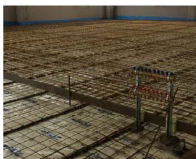
Particolare del tubo di riscaldamento
