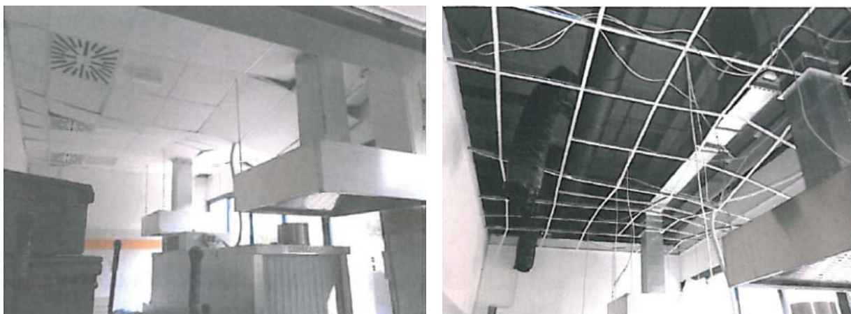
Cucina Controsoffitto aspirante
