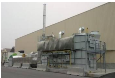
Impianti trattamento fumi
