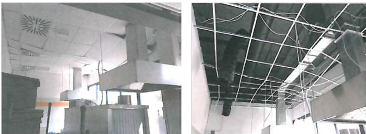
Cucina Controsoffitto aspirante
