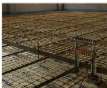
Particolare del tubo di riscaldamento
